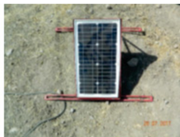
k) Solar Panel
