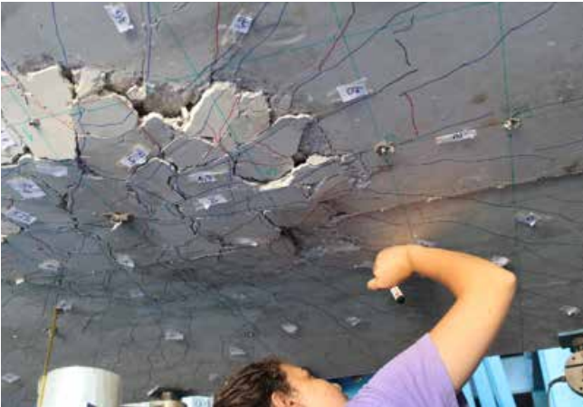
Şekil 4. Darbe deneyi sonrası hasar görmüş çelik fiber katkılı betonarme döşeme
