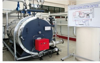
Buhar Kazanı Ünitesi
