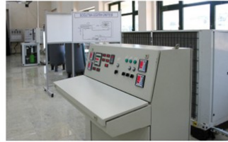
Isıtma - Soğutma Ünitesi
