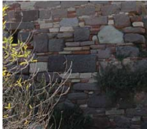
Şekil 59. Duvarların alt bölgelerinde ikinci düzeyde yapısal sorunlar.
