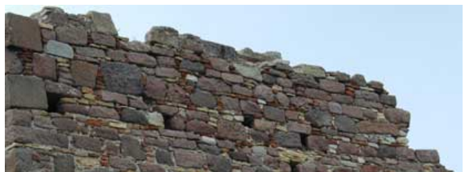
Şekil 60. Duvarların üst bölgelerinde üçüncü düzeyde yapısal sorunlar.
