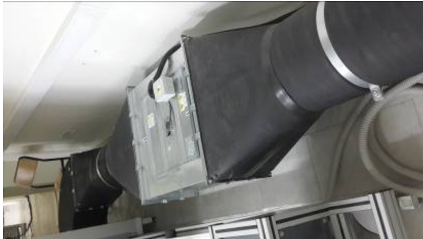
Şekil 62. Fan ve bağlantıları.
