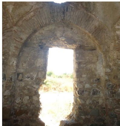
Figure 4.70. East arch plaster of Soyunmalık
