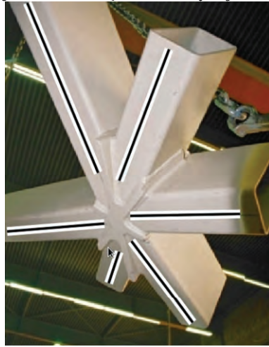
Şekil 20: Burulma ve düğüm noktası. Çoğu örnekte, destek elemanlarının birleşim noktalarının düzgün birleşimlere sahip olmadığı gözlemlenebilmektedir. (Waagner-Biro Stahlbau)
