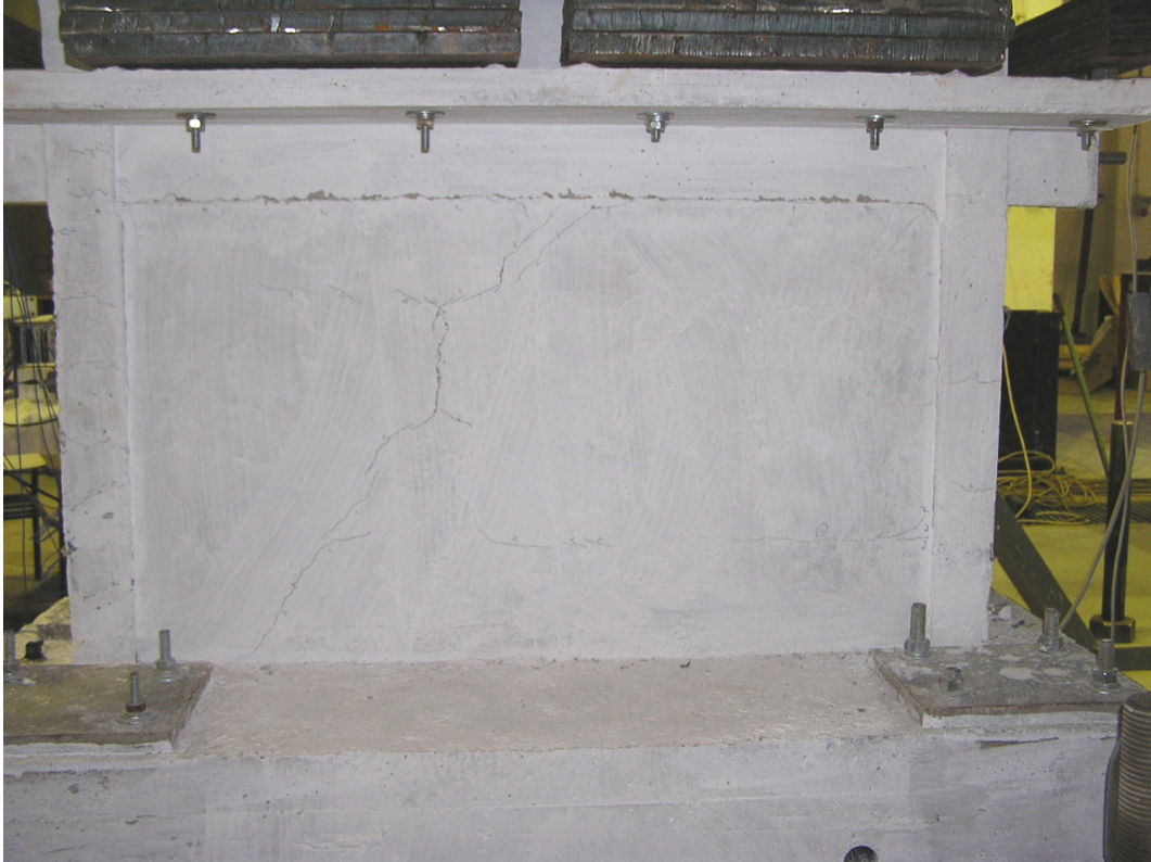
Şekil 4.35 Grup 2 yüklemeleri sonrası 1. kat güney yüzünde oluşan hasarlar
