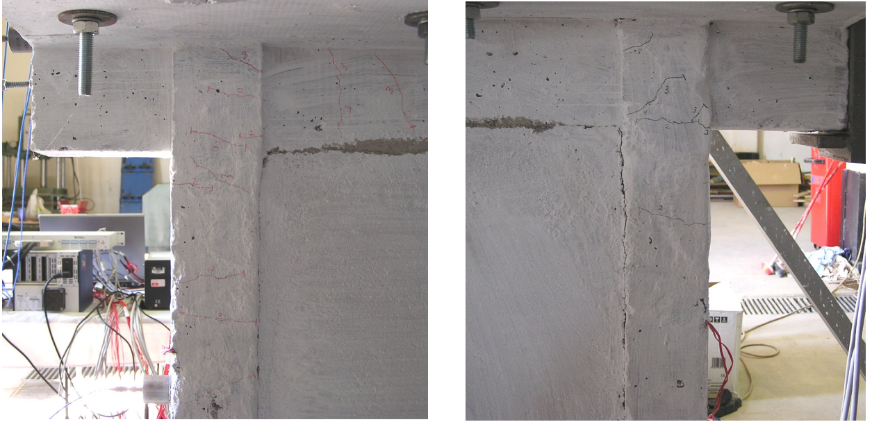
Şekil 4.49 Grup 3 yüklemeleri sonrası 1. kat kolonları düğüm noktalarında oluşan hasarlar
