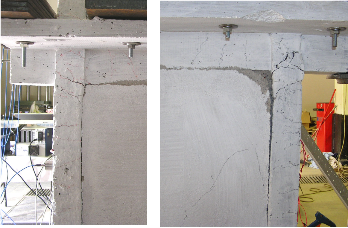
Şekil 4.52 Grup 5 yüklemeleri sonrası 1. kat güney yüzünde oluşan hasarlar
