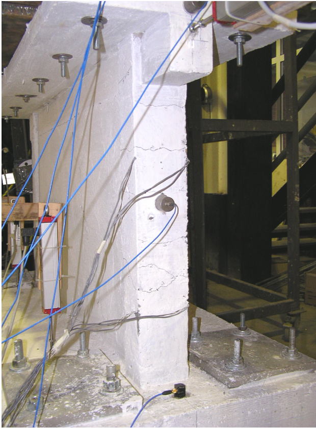
a) Kolonda oluşan eğilme çatlakları
