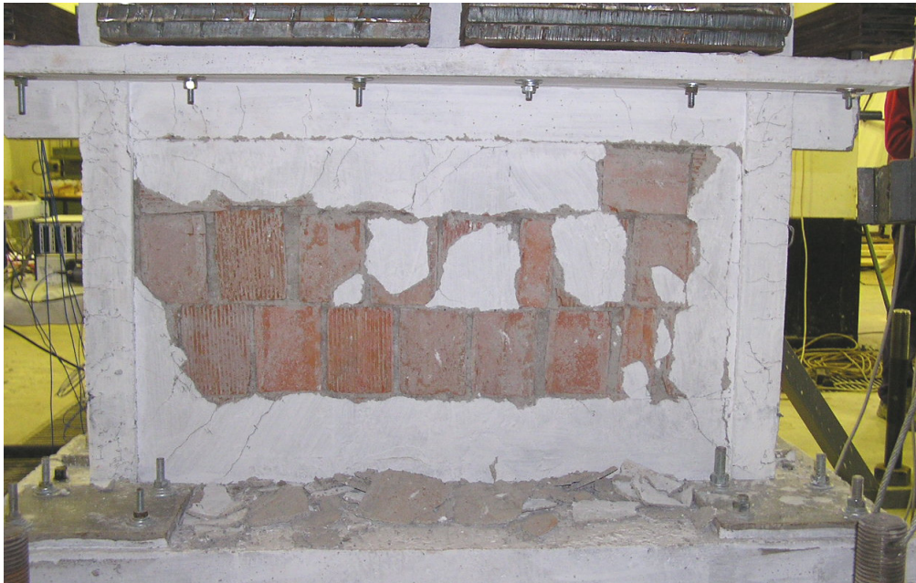
Şekil 4.44 Grup 6 yüklemeleri sonrası 1. kat güney yüzünde oluşan hasarlar
