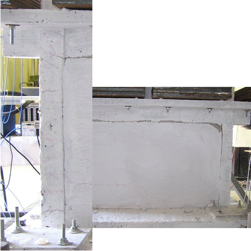
Şekil 4.51 Grup 4 yüklemeleri sonrası 1. kat güney yüzünde oluşan hasarlar
