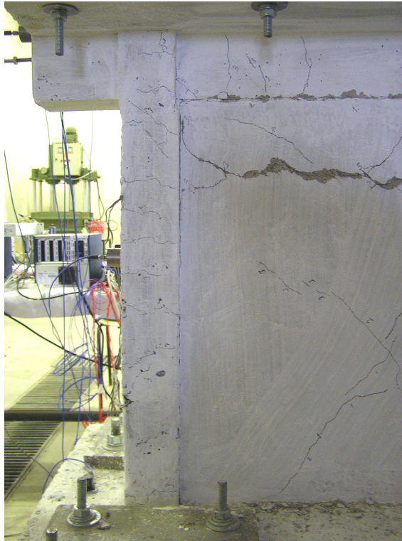
Şekil 4.37 Grup 3 yüklemeleri sonrası 1. kat batı kolonu güney yüzünde oluşan hasarlar
