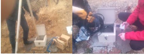
Şekil 4. Nem sensörlerinin kuyu montajı
