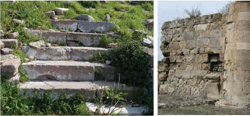
G. 8. İkinci Durum Sınıfındaki Bölgeler, solda kilisenin merdiveni (Emre İpekci, 2015), sağda Çardak Han barınak kuzey duvarı, güneydoğu köşesi (Feyza Durmuşlar, 2017)
